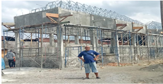
Gambar 3. Proyek Pembangunan fasilitas Park And Ride Sleman Yogyakarta dengan Atap Baja Ringan
